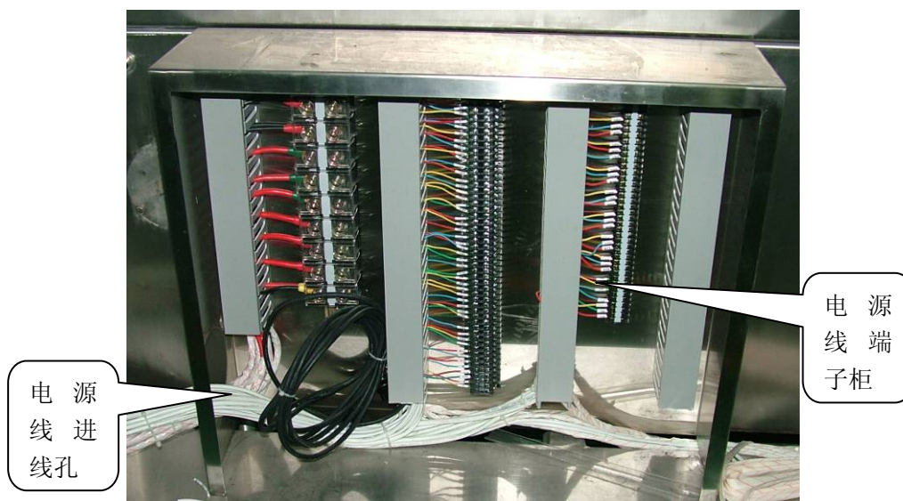
图 3-10 电源线端子柜和进线孔
