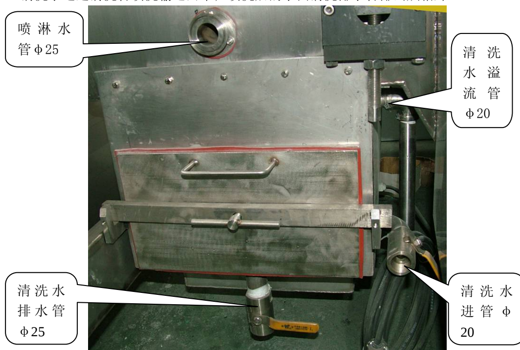
图 3-7 清洗水箱及其管道
