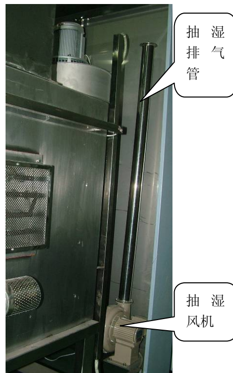
图 3-3 抽湿风机及排气口
